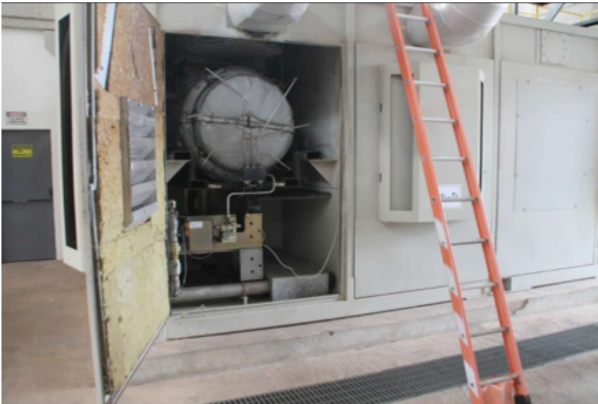
Figura 12 – Microturbina instalada na ETE Arrudas Fonte: Brasil, 2017
