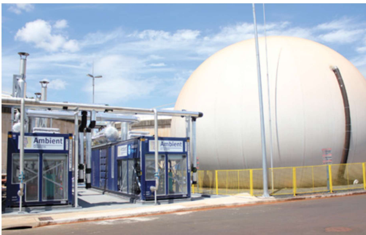
Figura 13 – Gasômetro e CHP instalados na ETE Ribeirão Preto. Fonte: GUASCOR (2015)
